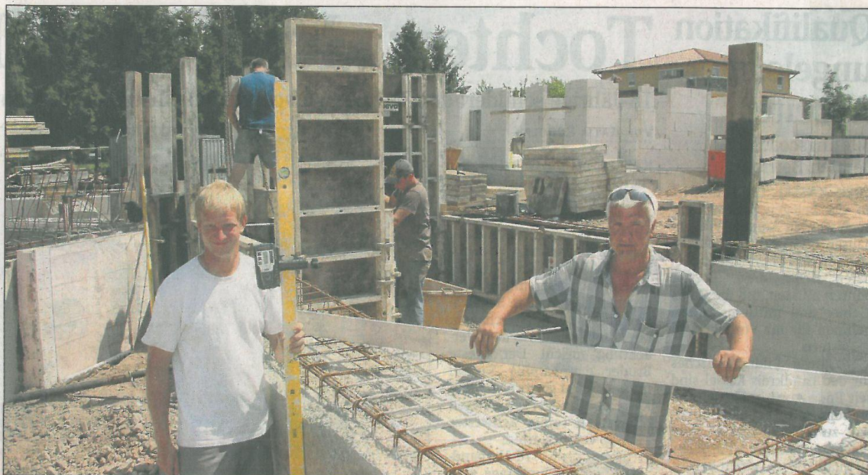
Im kommenden Sommer ist Einzug: Seit April brummen die Bagger schon auf der Baustelle. Im August 2016 soll die Erweiterung der Wohnanlage abgeschlossen sein. 42 alte Menschen finden hier dann ein neues Zuhause.
